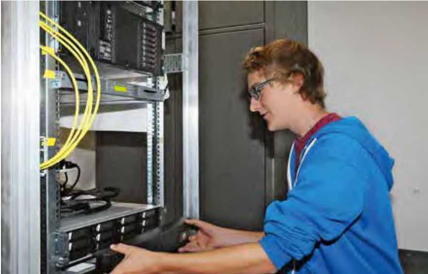
Lukas Oberholzer präsentiert stolz seine praktische Abschlussarbeit: eine von ihm entwickelte Serverkonstruktion, welche gleichzeitig die Ausfallsicherheit und die Performance erhöht.
