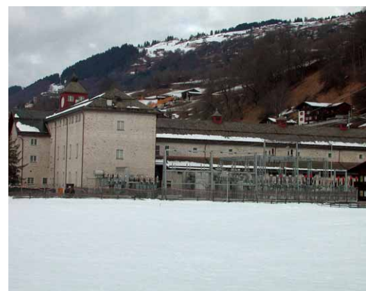
Der Ausbau der Wasserkraft, hier die Zentrale der Rätia Energie in Küblis, ist eine der Massnahmen, die prophezeiten Stromlücken zu schliessen.
